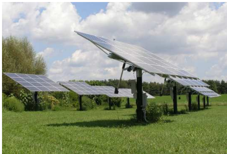
Rys. 7. Konstrukcje tracker'a z panelami słonecznymi [34]
