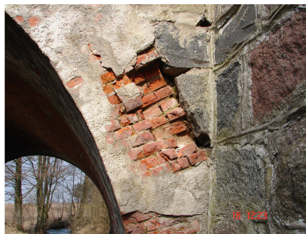
Rys. 2. Most w Kołodziejkach – widoczne ubytki cegieł
