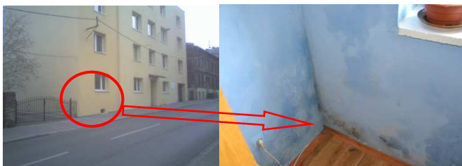
Rys. 1. Zawilgocenie i zagrzybienie budynku po dociepleniu
