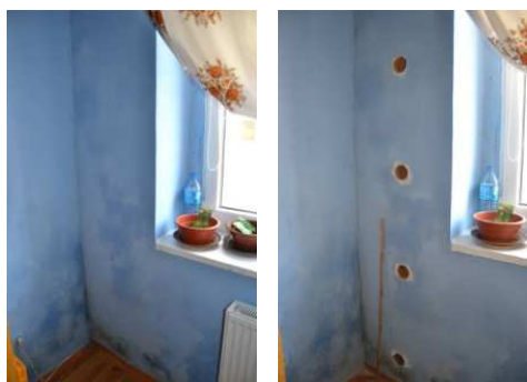
Rys. 2. Zawilgocenia ścian parteru po dociepleniu, z miejscem pobrania próbek
