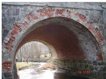
Rys. 1. Most w Kołodziejkach – stan przed przebudową
