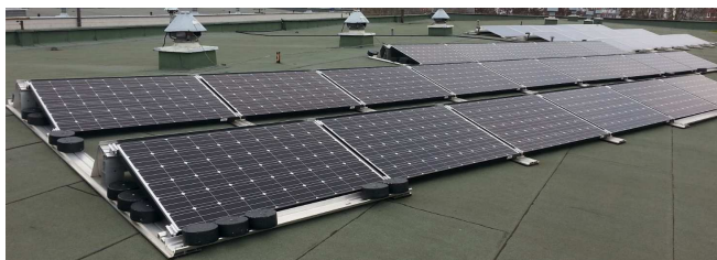
Rys. 4. Instalacja fotowoltaiczna na WIM UTP w Bydgoszczy [9]
