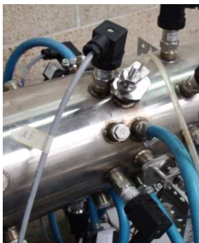
Rys. 4. Sondy Pito i ciśnienia statycznego zamontowane na korpusie stanowiska
