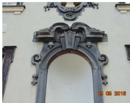
Rys. 6. Uszkodzenia i zanieczyszczenia obramienia dużej niszy Fig. 6. Damage and contamination of the large niche framing
