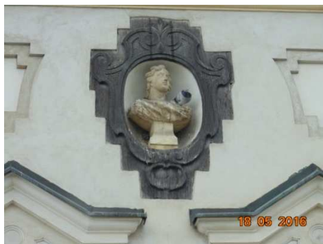
Rys. 5. Uszkodzenia i zanieczyszczenia obramienia niszy z popiersiem Fig. 5. Damage and contamination of the niche with a bust framing
