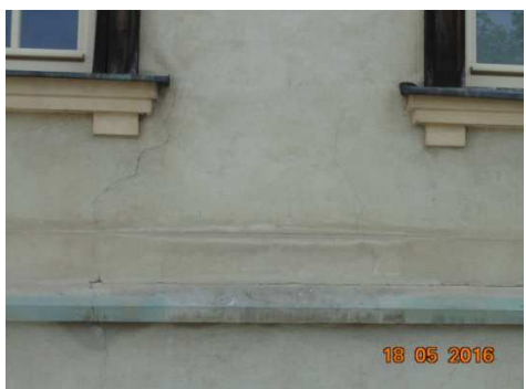
Rys. 11. Zarysowania elewacji zachodniej Fig. 11. Cracks of the western façade
