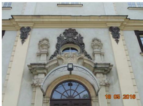
Rys. 7. Widok uszkodzeń portalu wejścia głównego
