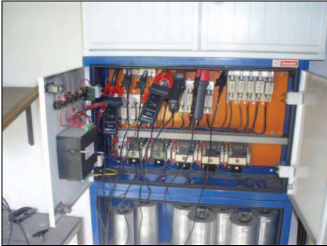
Rys. 6. Widok rozdzielni zakładu z zainstalowaną baterią kondensatorów
