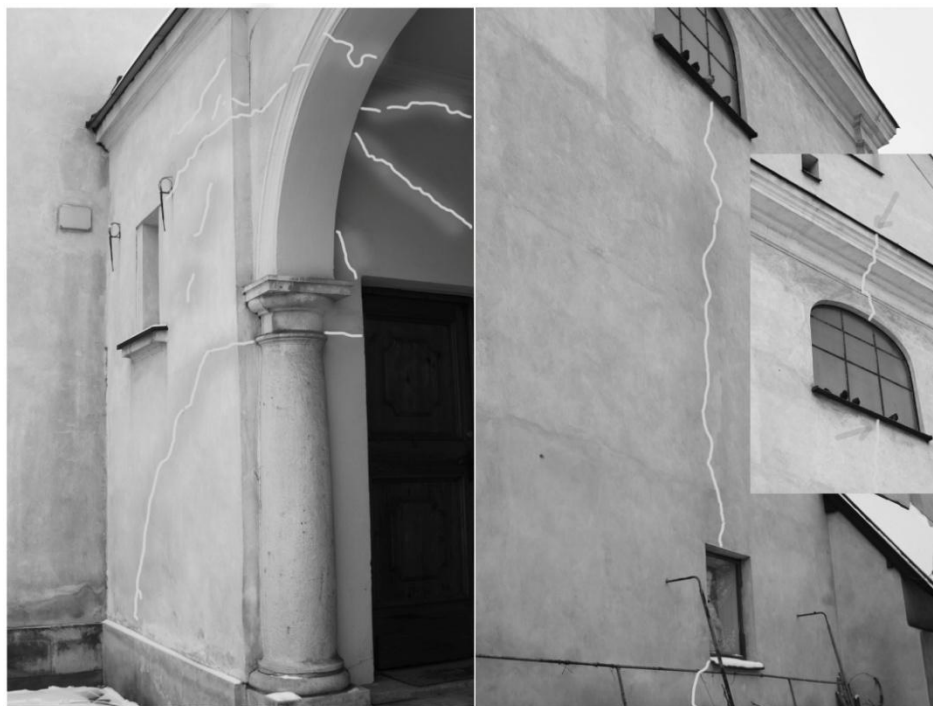
Rys. 10. Pęknięcia murów krużganków (lewy) i kościoła św. Józefa (prawy)
