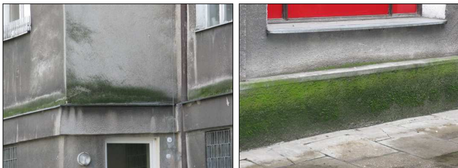
Rys. 2. Rozwój korozji biologicznej na ścianach budynków mieszkalnych w najstarszej części Nowej Huty w Krakowie (fot. T. Kusionowicz)
