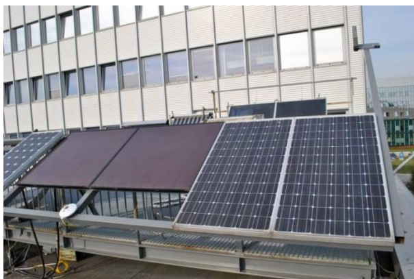
Rys. 3. System fotowoltaiczny Zakładu Termodynamiki i Mechaniki Płynów
