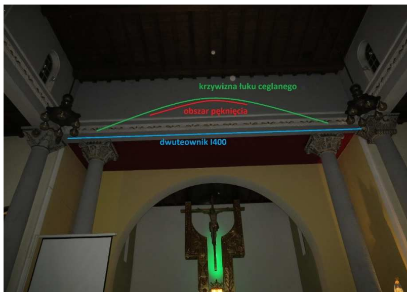
Rys. 5. Miejsce pęknięcia – widok z wnętrza kościoła (Autor, 2016)
