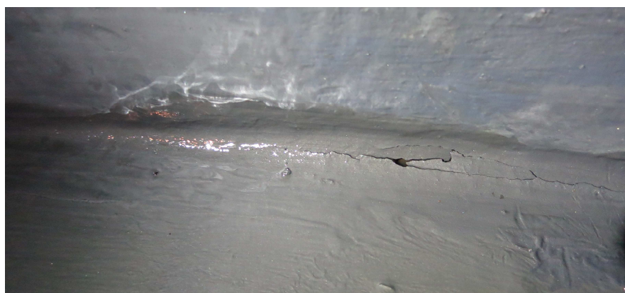
Rys. 3. Pęknięcie warstwy laminatu na styku pomiędzy płaszczem i dnem zbiornika (zdjęcie J. Siudut)
