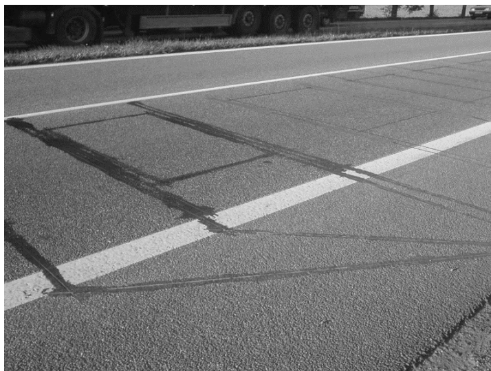
Rysunek 16 Pętla indukcyjna zatopiona w jezdni; Źródło: https://przeglad-its.pl/2014/07/25/petlowy-system-detekcji-ruchu-z-wykrywaniem-osi-pojazdow/
