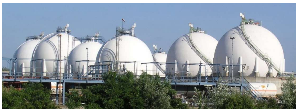
Rys. 5. Sferyczne ciśnieniowe magazyny gazu w rafinerii ropy naftowej MiRO w Karlsruhe
